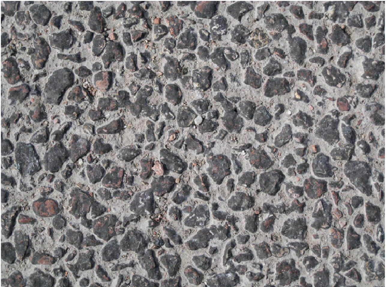
Figur 2.5. Exempel på en kraftigt igensatt beläggning där permeabiliteten samt den bullerreducerande effekten är förlorad.
