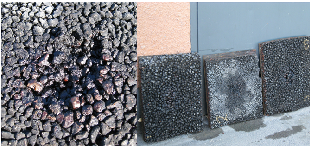
Figur 5.3 Exempel på typiska skador orsakade av en kombination med högt tryck och hetvatten.
